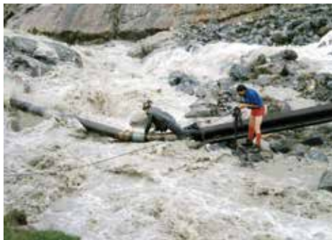
Nach Unwetter im Sommer 1987: Sektionsmitglieder am Turbinenwasserrohr
